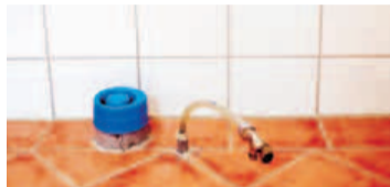
PROPP. Kommunen fjernet toalettet på grunn av manglende utslippstillatelse.
